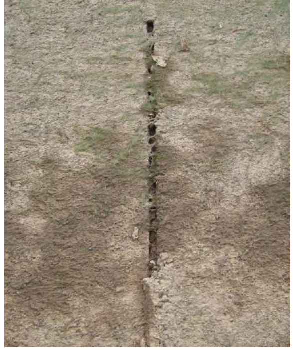
JUNTAS ANTES TRATAMIENTO
