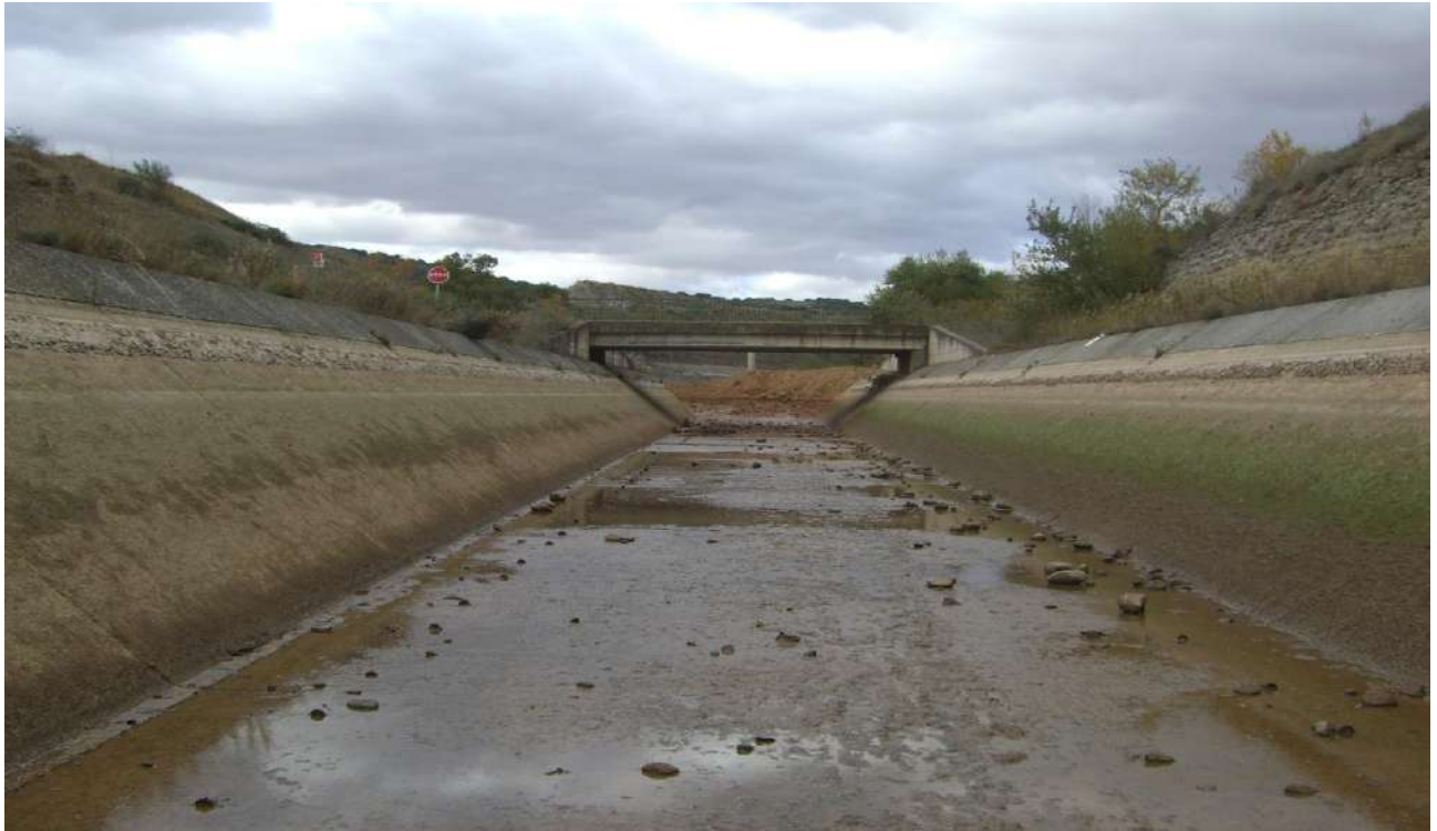
JUNTAS ANTES TRATAMIENTO
