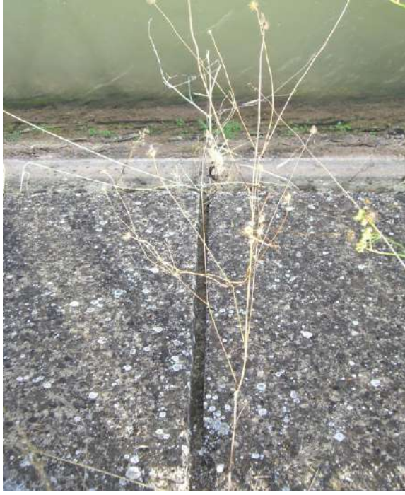
JUNTAS ANTES TRATAMIENTO
